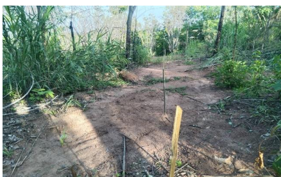
การทำหลักและปักหลักหมายแนวปลูก 170 ไร่ โครงการเชื่อมแควน้อยอันเนื่องมาจากพระราชดำริ (ส่วนที่ 2) จังหวัดพิษณุโลก
